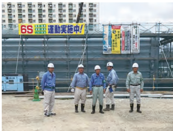
東大阪配水場作業所
