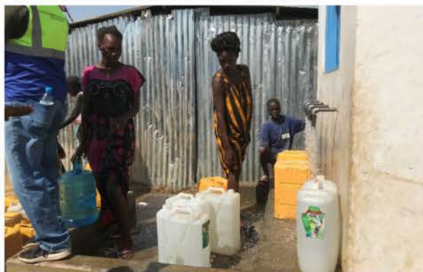
新設の共同水栓から地元住民に水が供給されている
